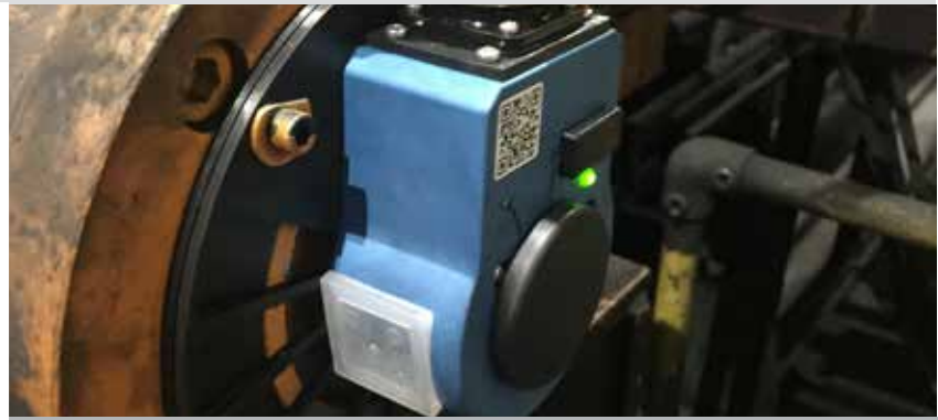
AV32 - Förderanlage / Conveyor
